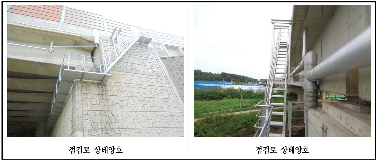
【사진 27.3.26】 교량 점검시설 손상현황
